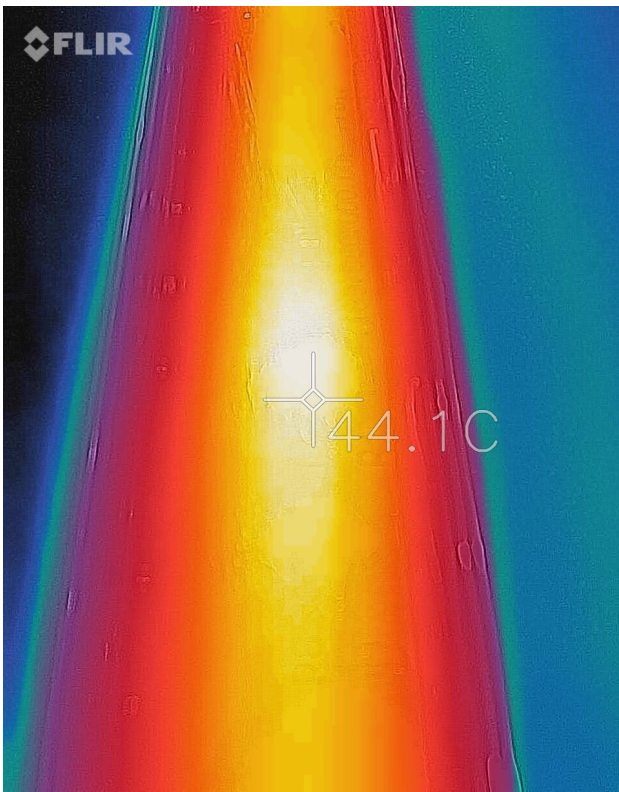
Img 3 FLIR Thermal Image
